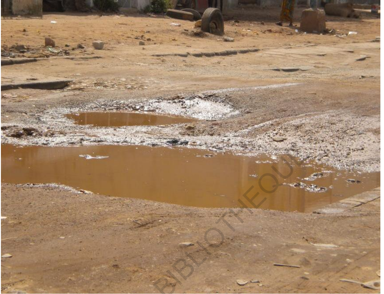
Photo 7 : La dégradation du réseau routier à Dakar en saison pluvieuse
