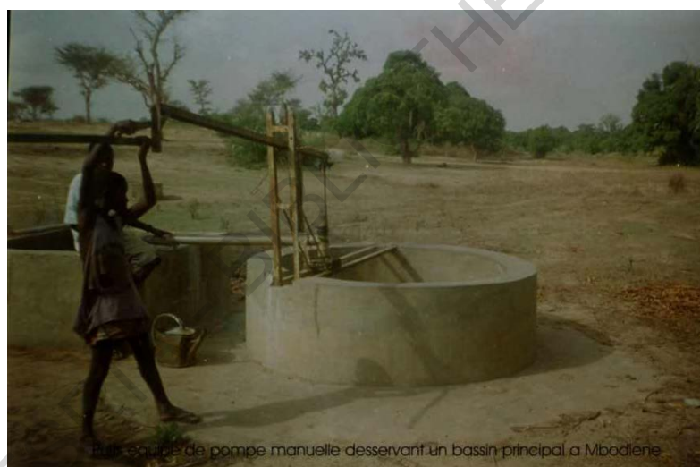
Photo 15 : Puits équipé de pompe manuelle, bassin principal reliant les bassins secondaires implantés dans une exploitation ( bas-fonds de Mbodiène, Sous bassin versant Noto_Jobas)
