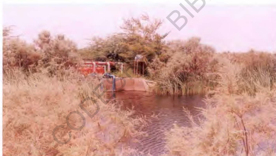
Photographie 4 : Station de pompage équipée d'un groupe électrogène, de deux pompes électriques, d'une pompe diesel et de 8 filtres à gravier dont le bassin de dissipation a une capacité de 6000 m 3 avec des points de contrôle des niveaux d'eau traitée pour l'irrigation de toute la Ferme.
