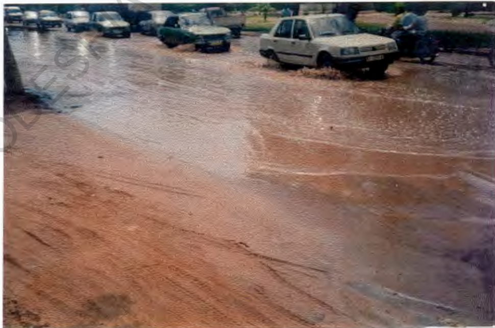
Photo N° 2 : Avenue Jean-Paul II, bitumée. Le système de drainage est défaillant.
