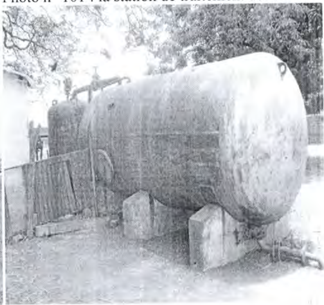
Photo n° 101 : la station de traitement des eaux.
