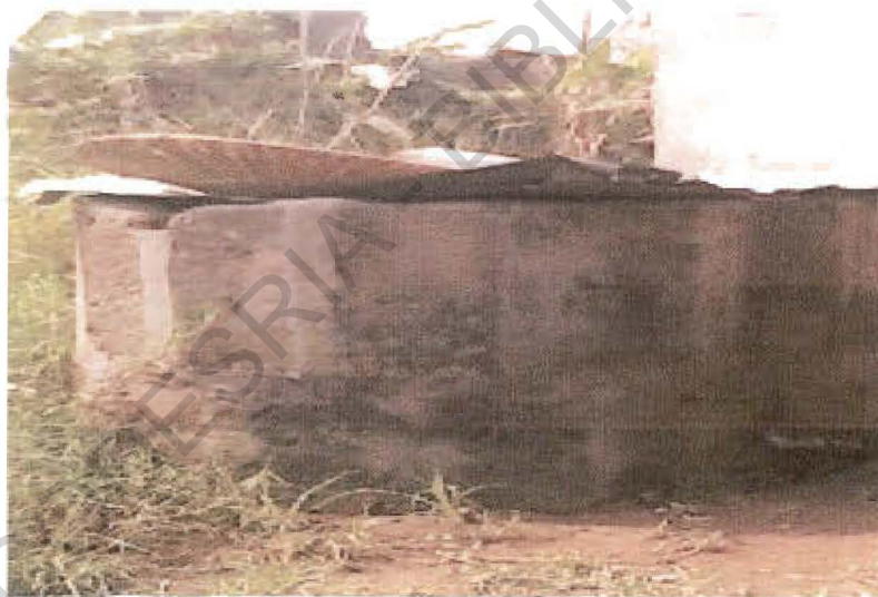
PHOTO N°III : Puits fermé avec des tôles rouillées.
