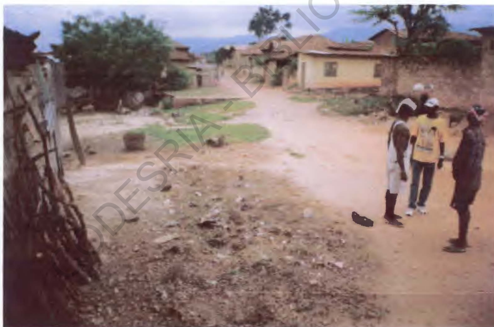
Photo n°30 : L'état dégradé d'une rue à Kpadapé
