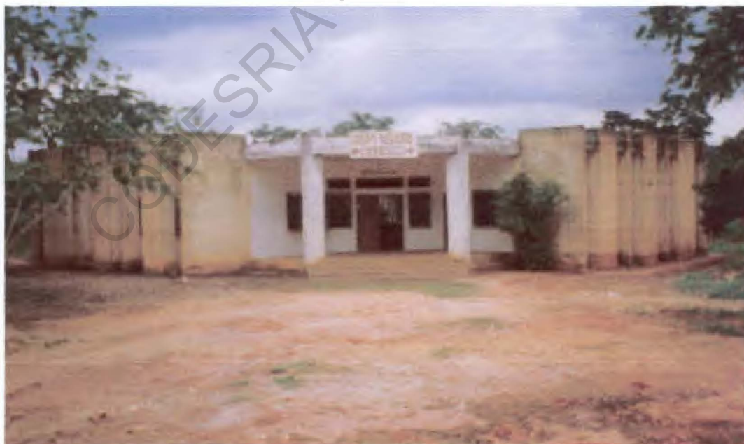
Photo n°32 : Un important dispensaire dans le Kloto, aujourd'hui frappé de délabrement
