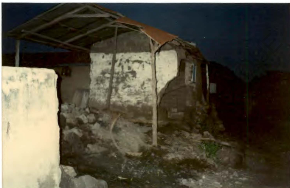
⑪ LOGEMENT EN BANCO DONT LES MURS SE SONT ECROULES.
