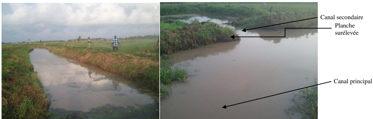
Photo11 : Collecteur principal d'eau
