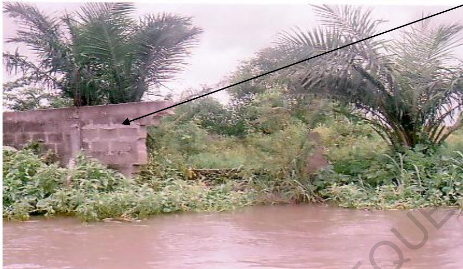
Photo 38: Destruction du mur du cimetière à Houédomè
